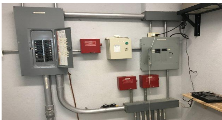
Foto 5. Cuarto de Controles Automatizados.
