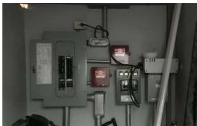
Foto 5. Cuarto de Controles Automatizados.
