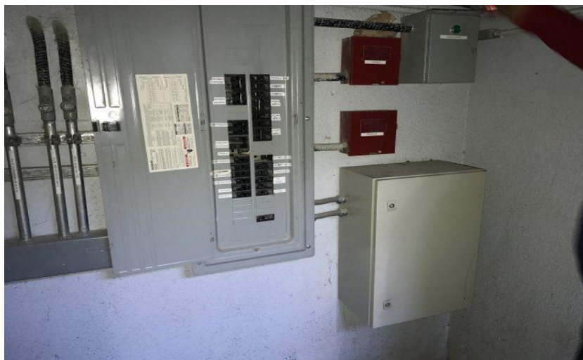
Foto 5. Cuarto de Controles Automatizados.
