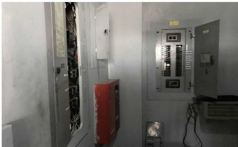
Foto 5. Cuarto de Controles Automatizados.
