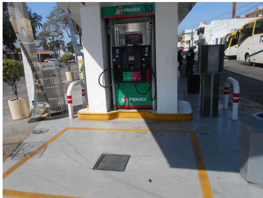
Figura 2. Dispensarios de la estación de servicio.
