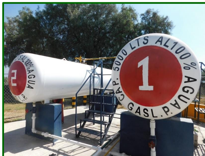
Imagen 3. Tanques de almacenamiento.
