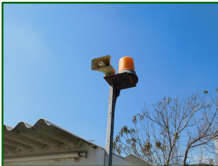
Imagen 7. Alarma Contra Incendio.
