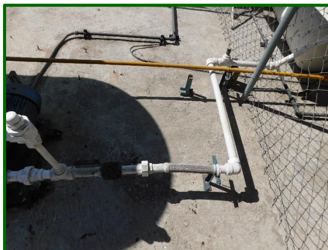
Imagen 5. Identificación de tuberías.
