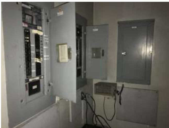
Foto 5. Cuarto de Controles Automatizados.
