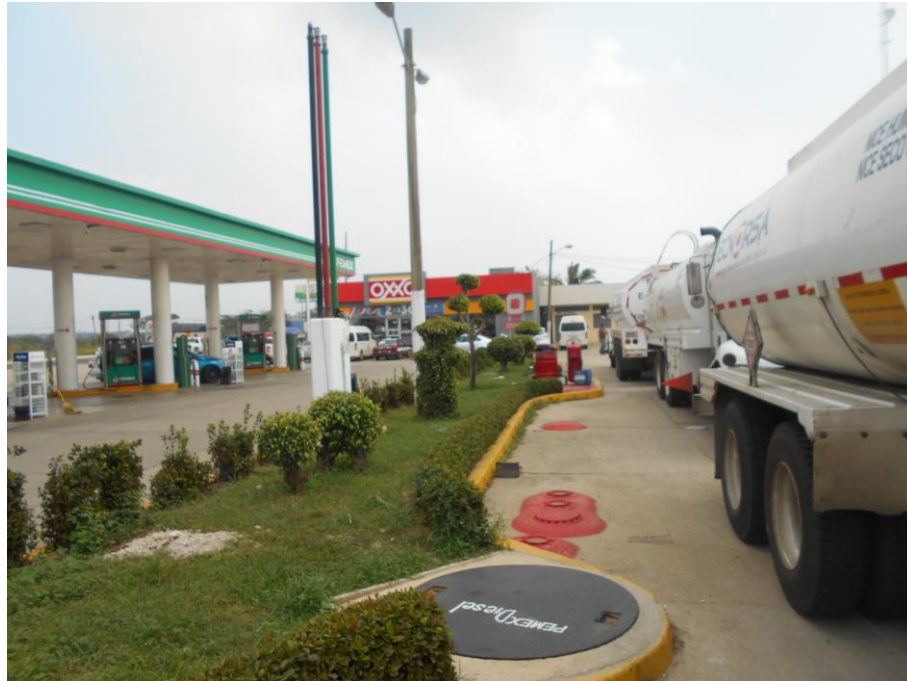
Figura 3. Área de tanques de almacenamiento.
