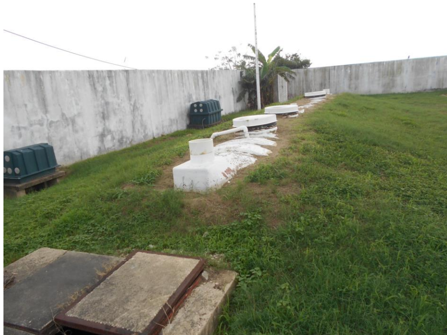
Figura 6. Planta de tratamiento de aguas residuales.
