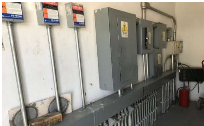
Foto 5. Cuarto de Controles Automatizados.
