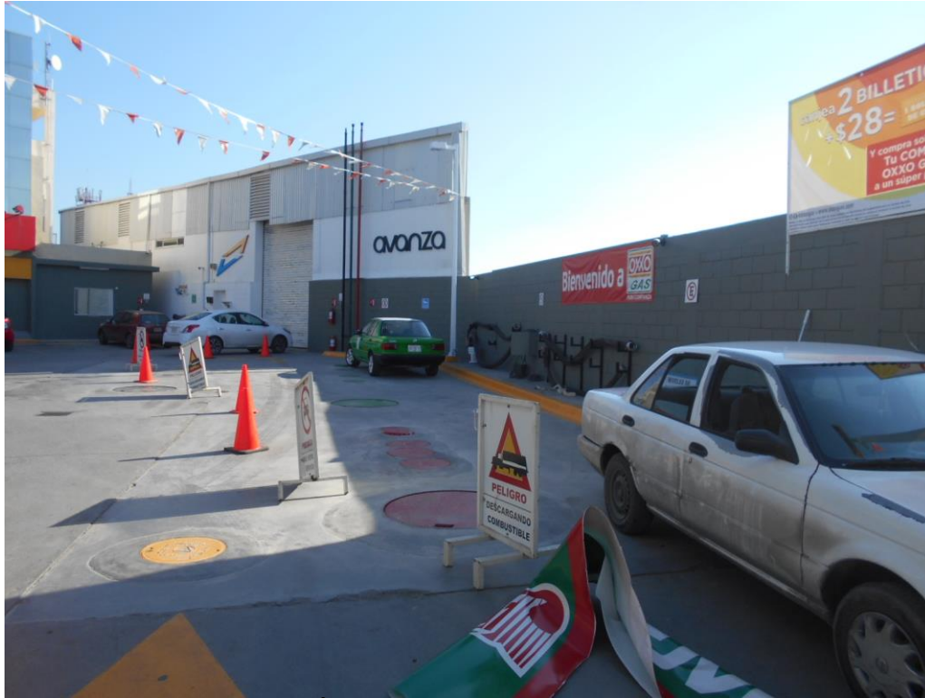
Figura 3. Área de tanques de almacenamiento.
