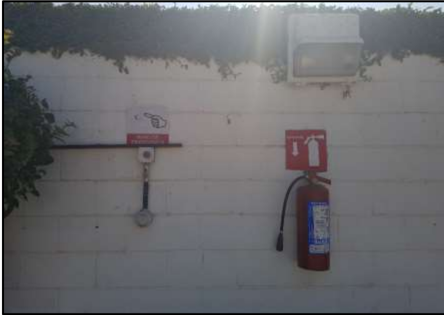
Fotografía 7. Extintor y paro de emergencia en barda perimetral junto a los tanques de almacenamiento.
