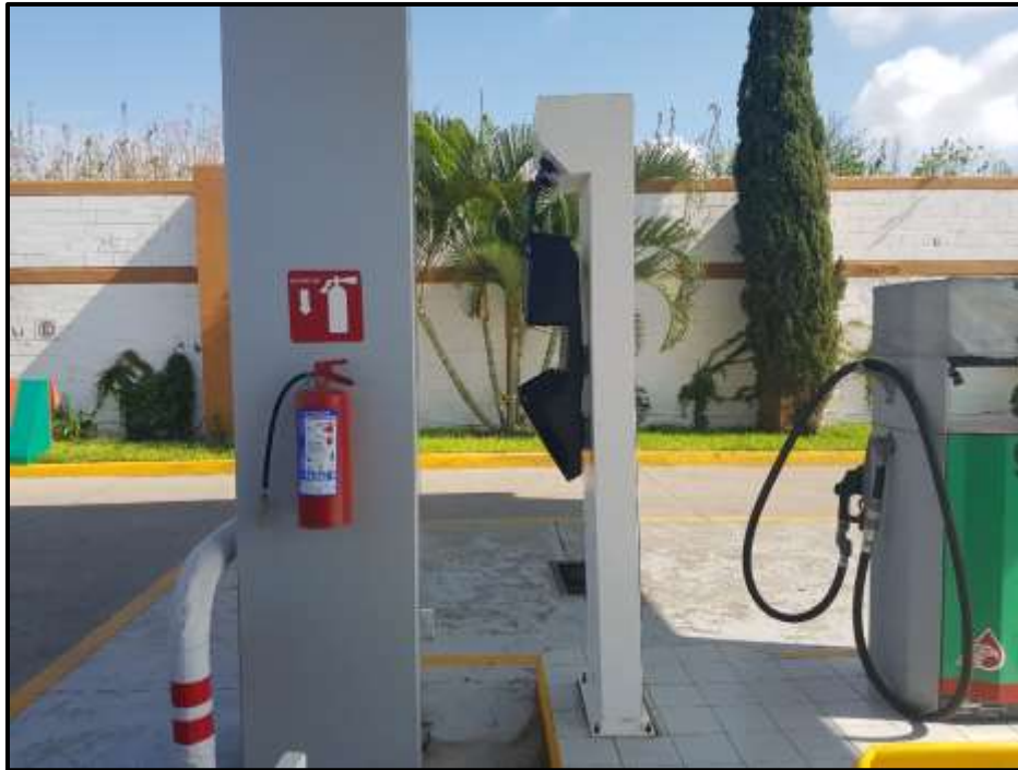
Fotografía 5. Extintor en zona de dispensarios.
