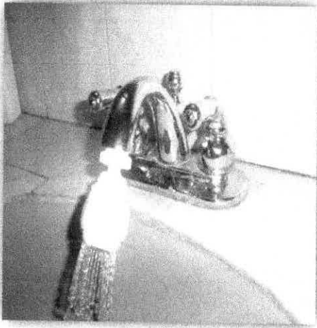
Imagen 17. La implementación de dispositivos en las llaves de los lavabos de los sanitarios realiza un ahorro del agua dentro de la estación de servicio.
