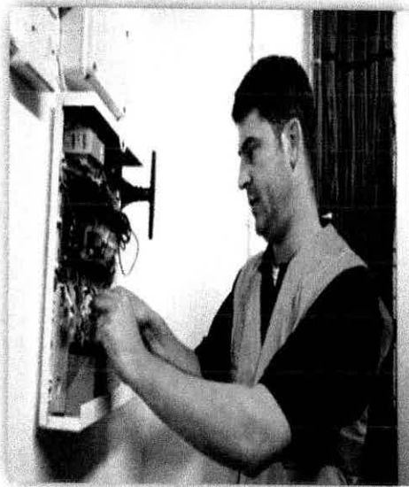
Imagen 23. La Comisión de Seguridad e Higiene revisa regularmente los equipos y dispositivos de la estación de servicio.
