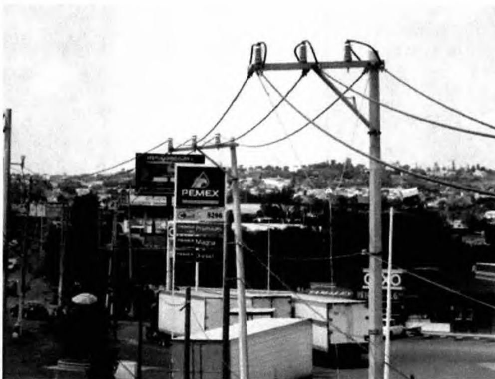
Figura 15.- Infraestructura de energía eléctrica.
