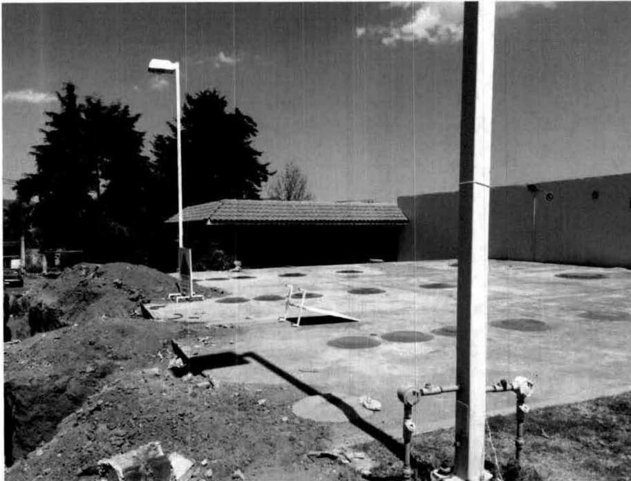
Área de Tanques de almacenamiento. Abril 2016
