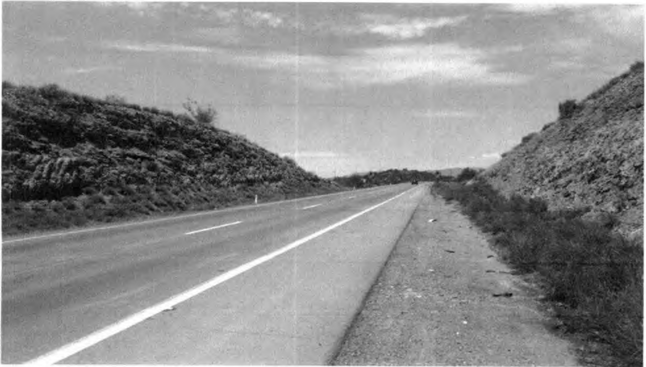
Fotografía 6. Vista de la carretera hacia el norte.
