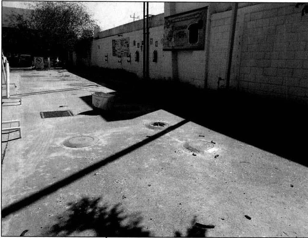
Figura 3. Área de tanques de almacenamiento.
