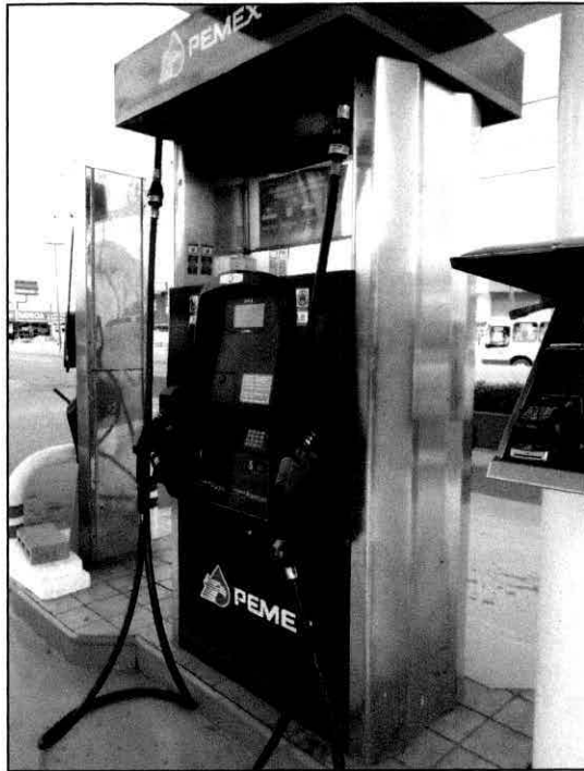
Imagen 3. Dispensario de combustibles. Se aprecia una posición de carga con dos mangueras, una para gasolina tipo magna y una para gasolina tipo Premium.
