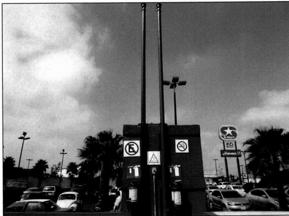
Imagen 6. Venteo normal de los tanques de almacenamiento. Se aprecia señalética restrictiva y preventiva, así como extintores.
