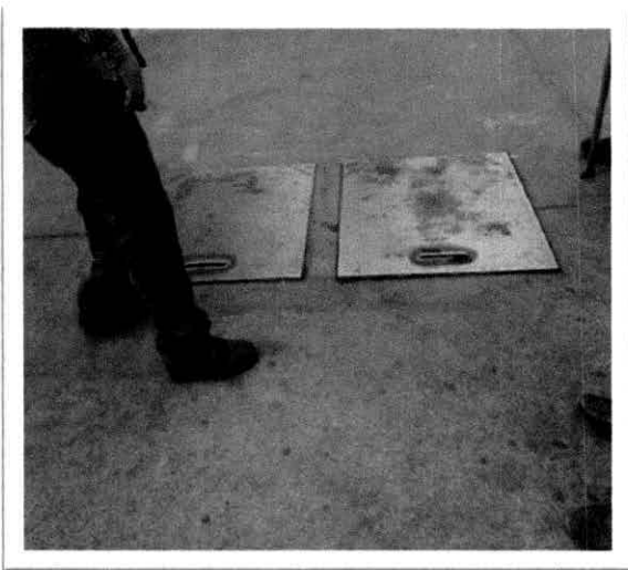
Fig. 5. Trampas de aceites y grasas en sus dos fases instalada en la estación de servicio.
