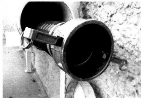
Vista de manguera de descarga de Combustibles, se observan los cinchos de sujeción.
