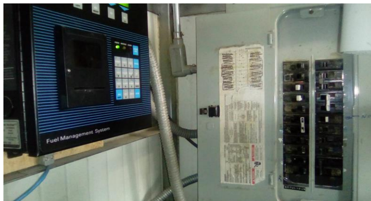
Foto 5. Cuarto de Controles Automatizados.
