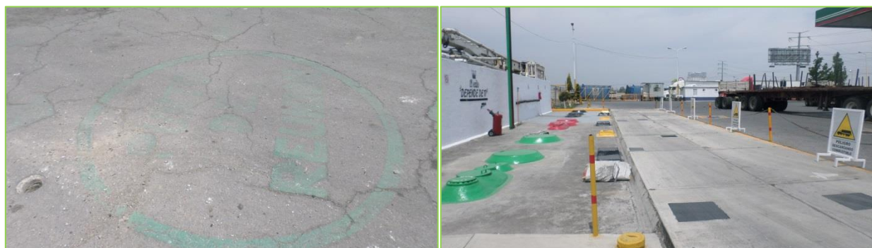
Figura 20. Estado actual de los pisos del área de almacenamiento de combustibles de la E.S. 06100.
