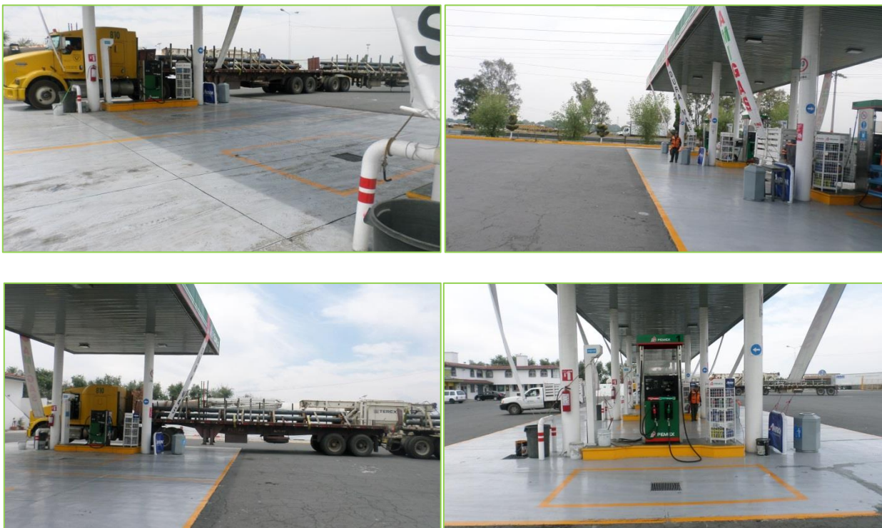
Figura 18. Estado actual de los pisos del área de carga de combustible de la E.S. 06100.
