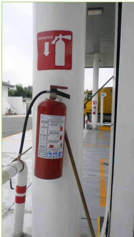
Extintores en zona de despacho.
