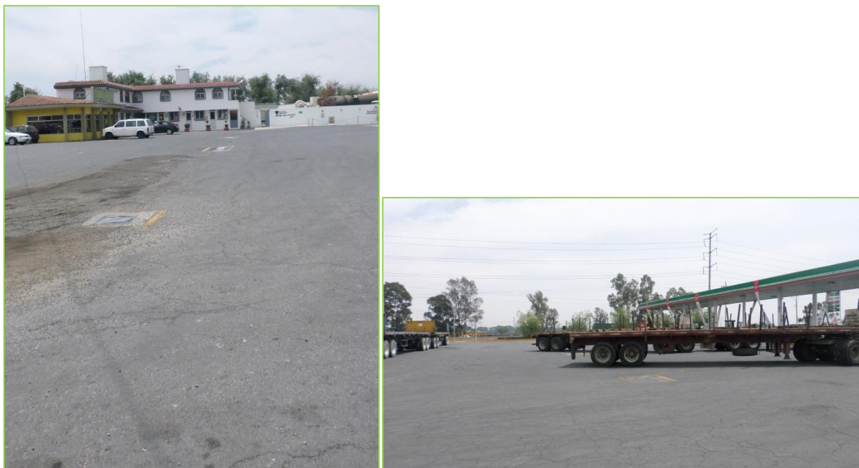
Figura 19. Estado actual de los pisos del área de circulación de vehículos de la E.S. 06100.
