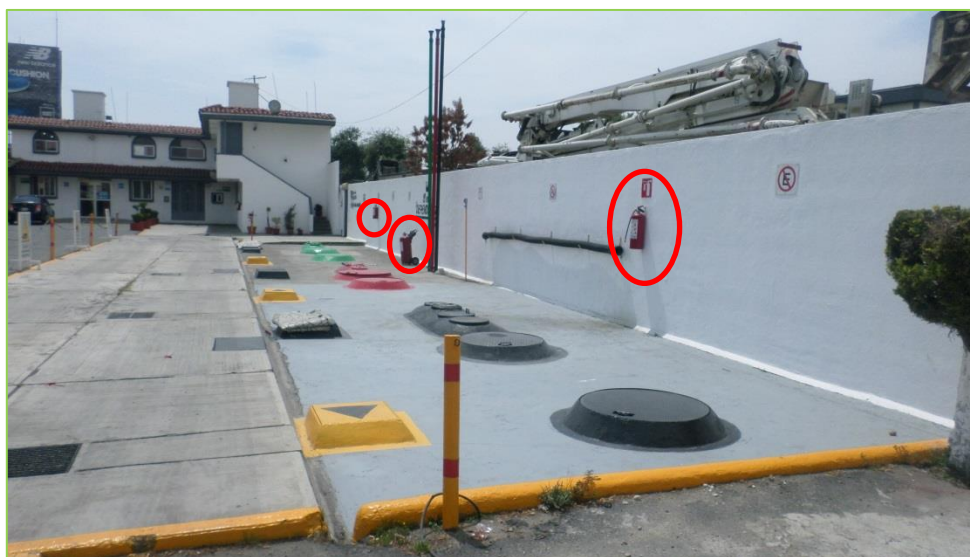
Extintores en zona de almacenamiento.
