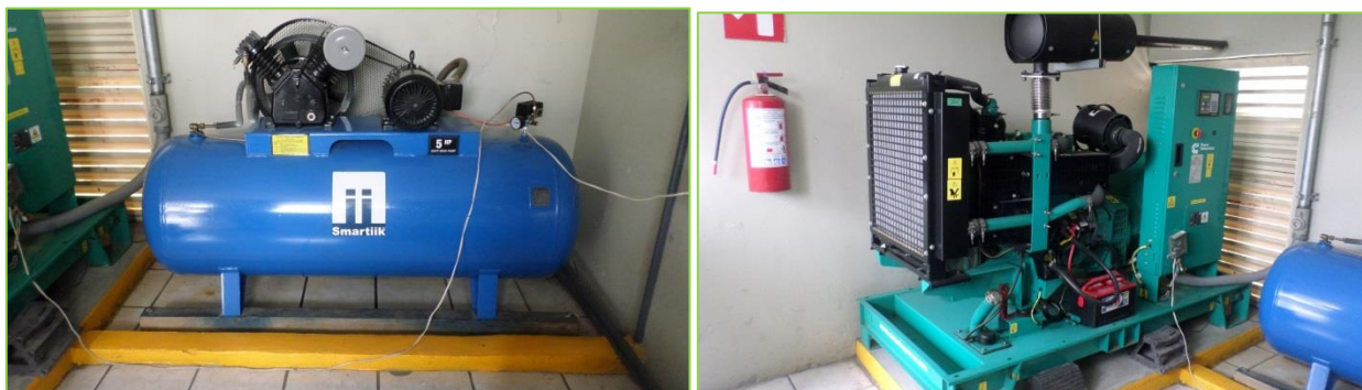
Figura 16. Cuarto de máquinas.
