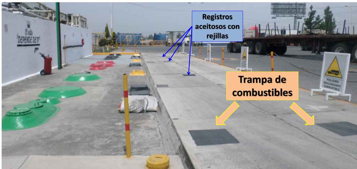
Figura 13. Trampa de combustibles.
