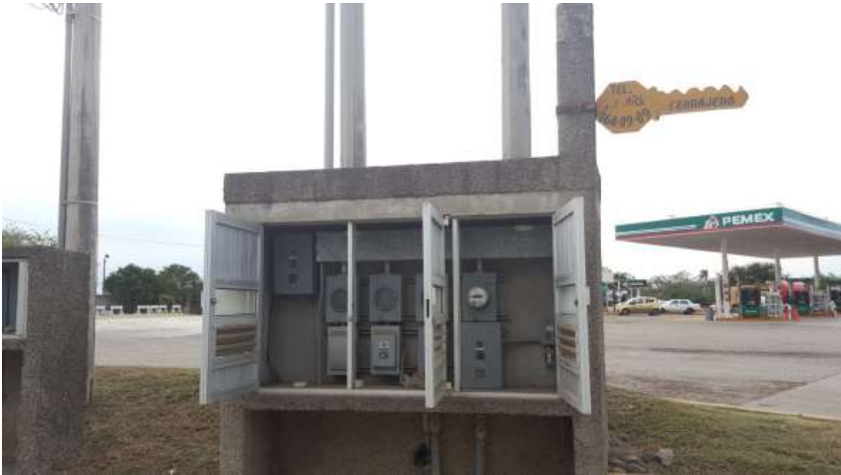
Subestacion Electrica de la Estacion de Servicio
