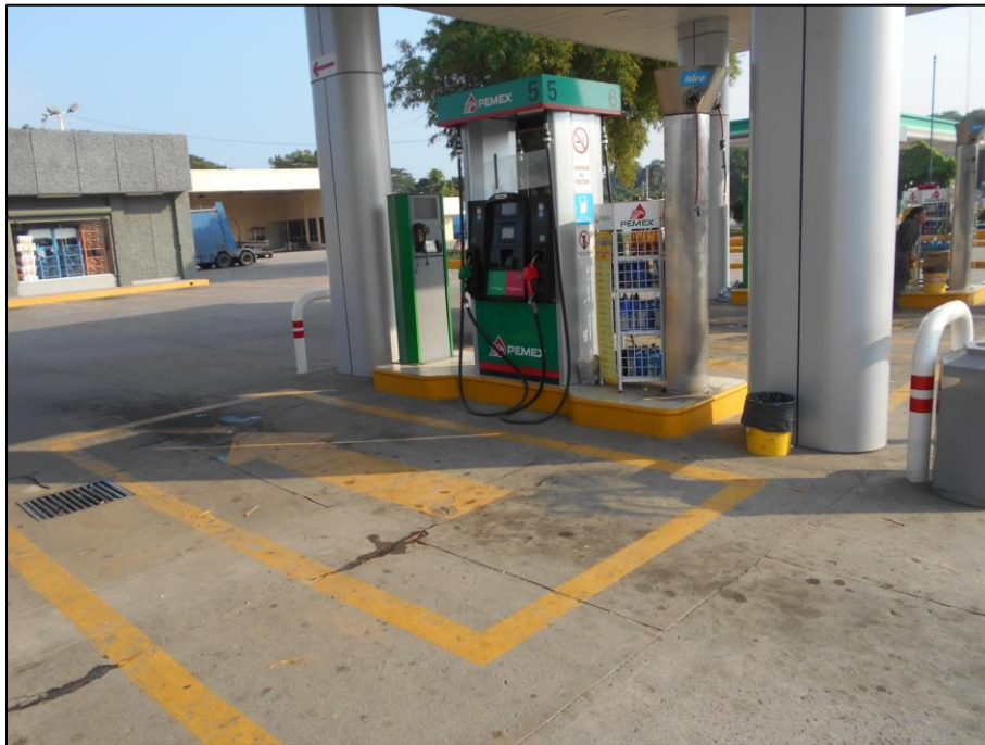
Imagen 2. Área de despacho.
