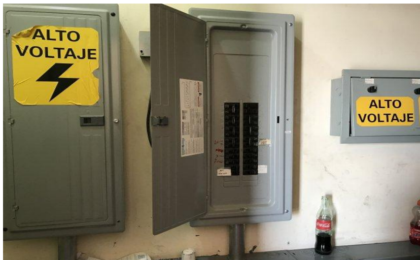
Foto 5. Cuarto de Controles Automatizados.
