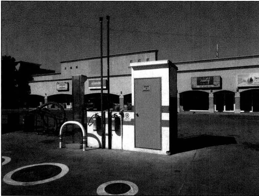
Imagen 3. Cuarto de máquinas de la estación de servicio.
