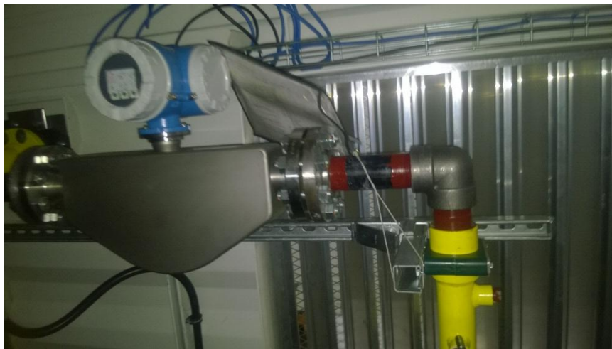
Fig. 6 Medidor (Sensor y transmisor 80E).
