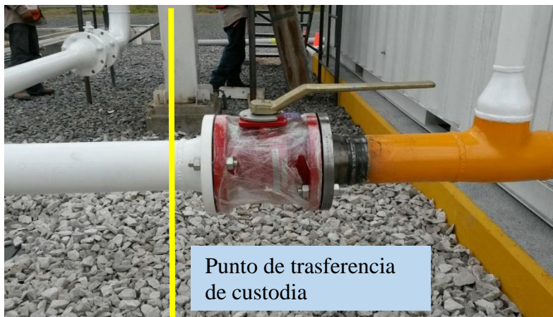
Fig. 5 Punto de transferencia de custodia.
