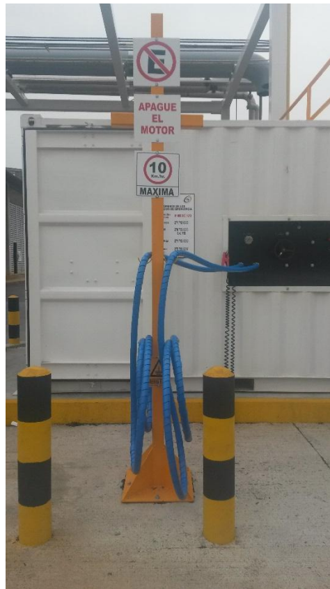
Fig. 3 Entrada de gas al descompresor.
