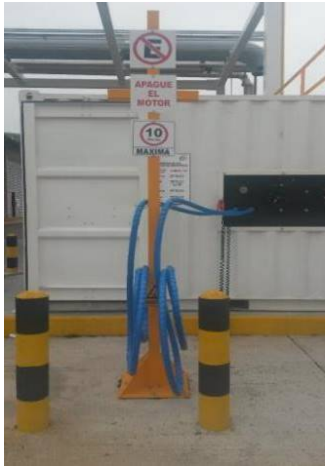
Figura 2 Manguera de suministro de GNC al descompresor (ejemplo)
