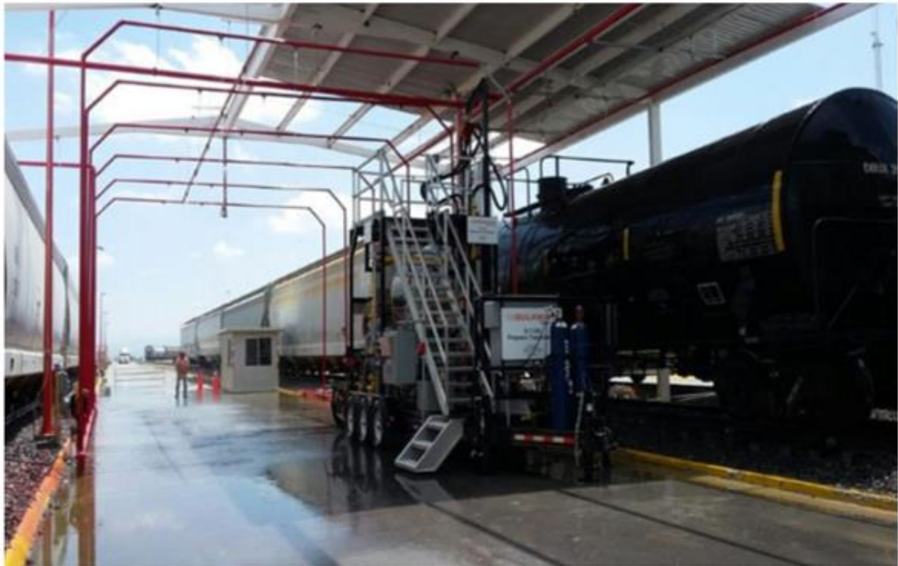
Fig. 10. Transloader para combustible gas L.P.
