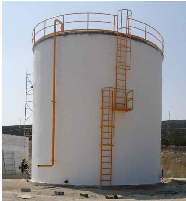
Fig. # 8. Tanque de almacenamiento de agua contra incendio
