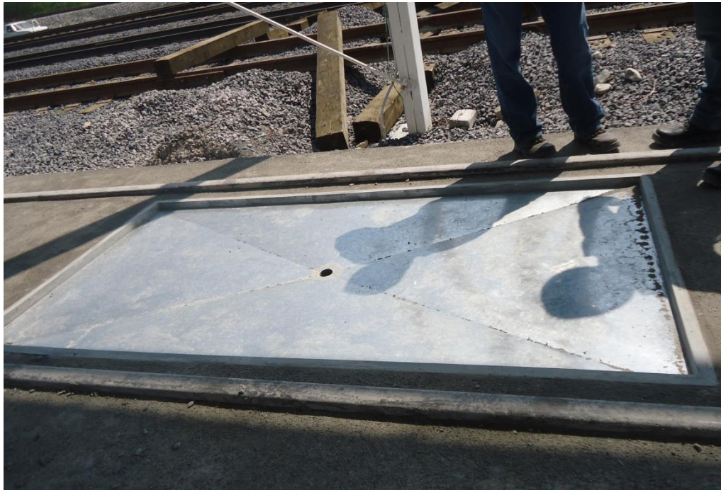
Fig. # 5 Charola fija para derrames en estación de trasvase de diésel.
