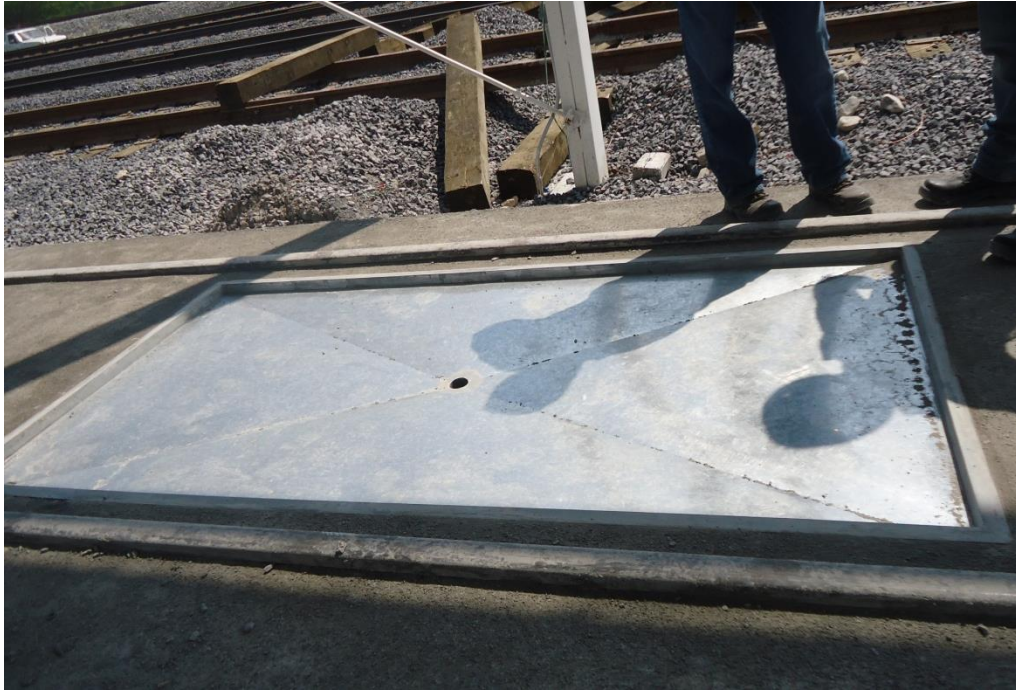
Fig. # 17. Charolas para canalización de derrames hacia fosa de contención.
