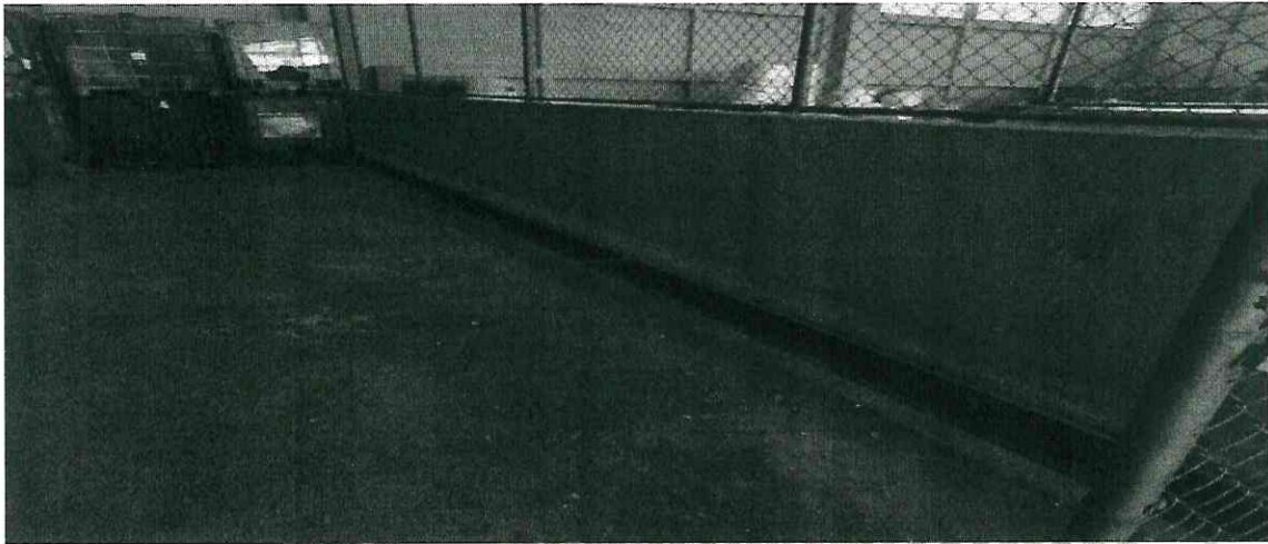
Canaletas que conducen a las fosas de lixiviados
