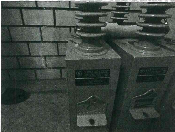
Capacitores libres de PCB's
