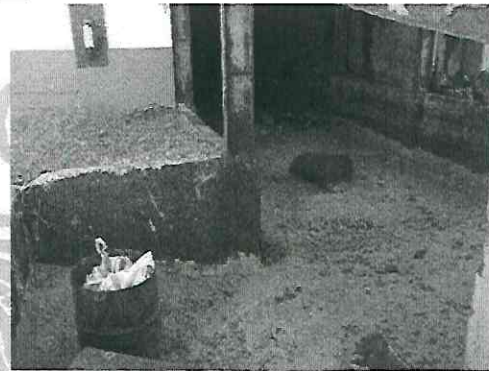
Canal de lixiviados central con lodo de hidrocarburo y tres tambores
