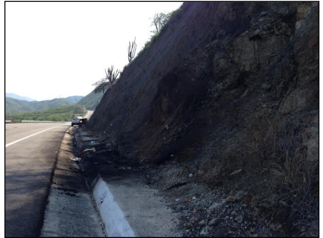
2.- Punto de impacto, en el cual se derramó Diésel sobre suelo natural.
