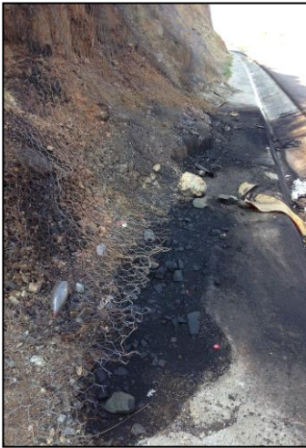
3.- El hidrocarburo derramado se incendió en el sitio del siniestro.
