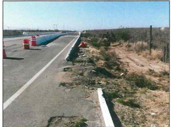
Señalización preventiva en el sitio del accidente.
