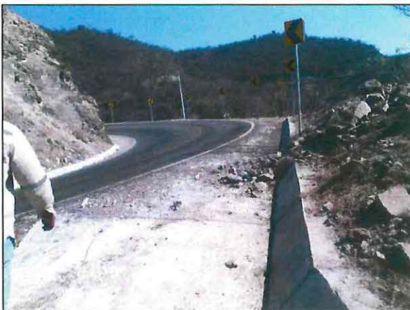
Punto de impacto, a la altura del Km. 089 + 700 de la Carretera (190) México – Ciudad Cuauhtémoc, en Oaxaca.
