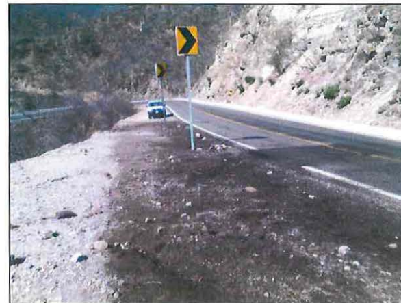
Suelo natural afectado por el derrame de Diesel en la meseta del derecho de vía de la Carretera (190).
