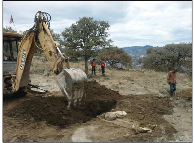
Con apoyo de retroexcavadora se extrajo el suelo natural contaminado con hidrocarburos (Diésel Industrial Bajo
