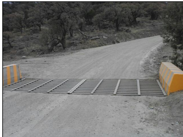
En el sitio se observa una bajada pluvial
