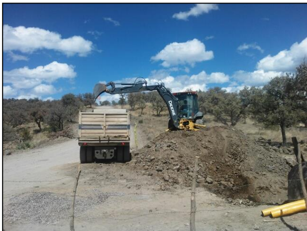
Acarreo de material edáfico contaminado hacia la celda provisional ubicada en la Mina Dolores
