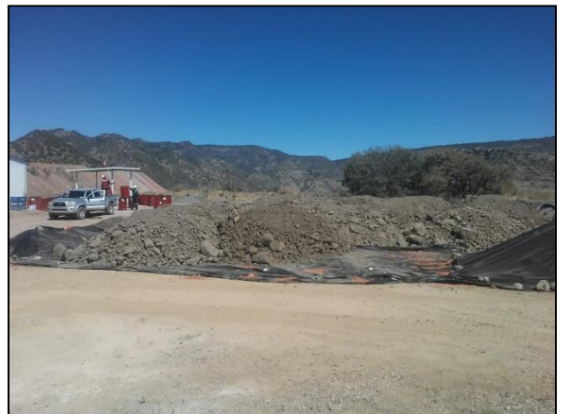
Depósito de material edáfico contaminado en la celda provisional.
