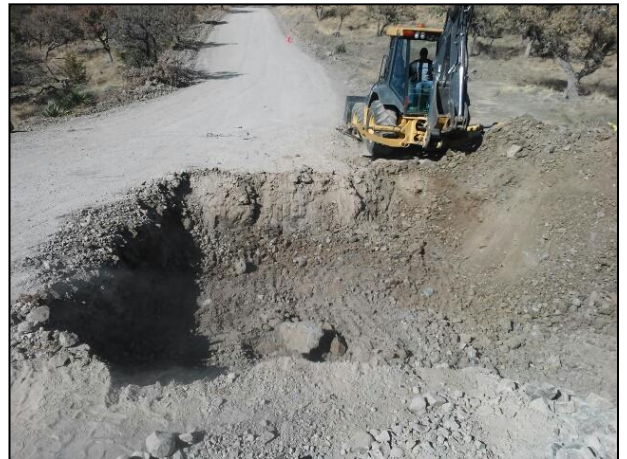
Fosa de excavación (Caja o zona de extracción), con una profundidad de alrededor de 1.5 m.
