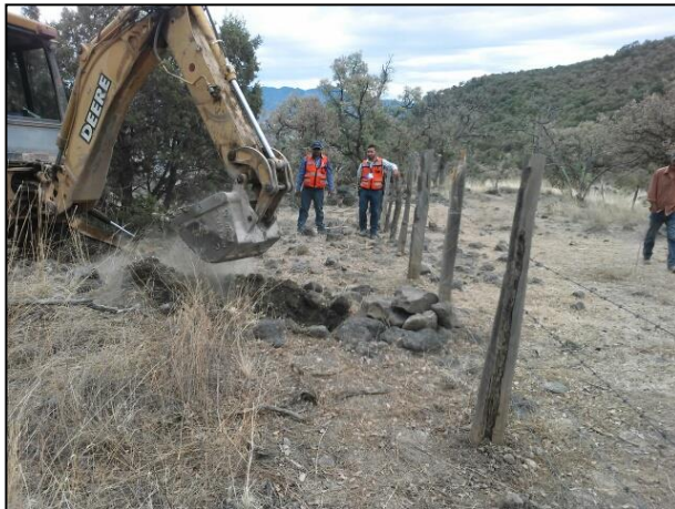
Extracción del material edáfico contaminado con Diésel Industrial Bajo Azufre en una parte del predio ejidal.
