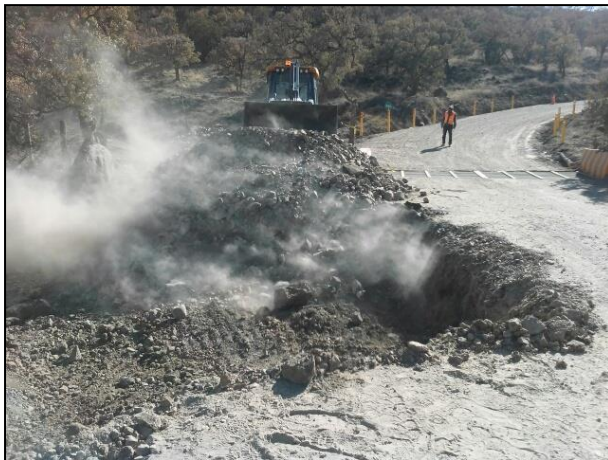
Colocación del material de relleno dentro de la fosa de excavación (caja o zona de extracción).
