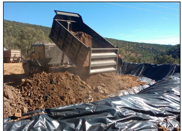
Depósito del material edáfico contaminado en la celda de tratamiento
