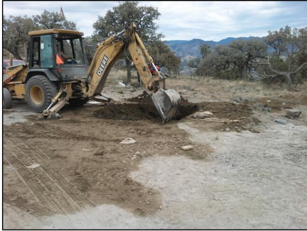
Extracción del material edáfico contaminado con Diésel Industrial Bajo Azufre en la zona contaminada.
