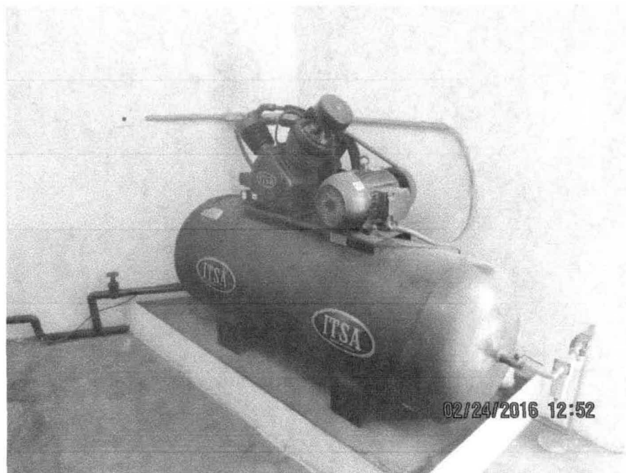
Fotografía No. 8.- Compresor.
