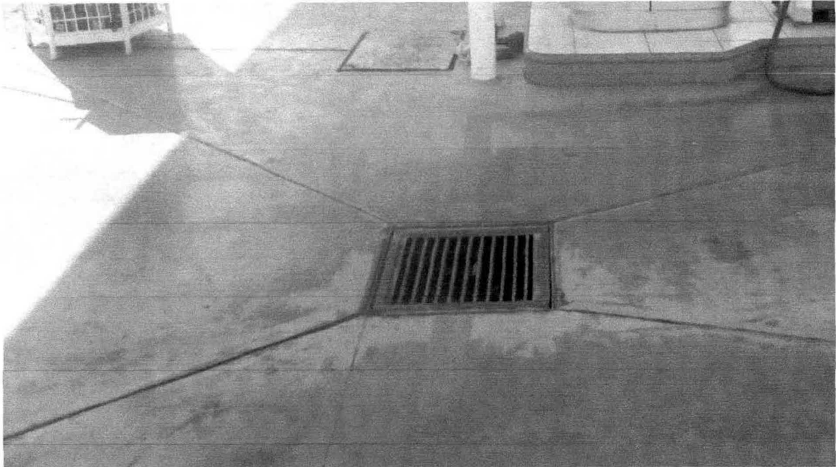
Fotografía No. 3.- colector de aguas aceitosas y con combustibles.
