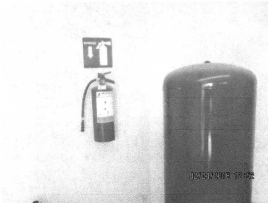
Fotografía No. 9.-Extintor en cuarto de máquinas.
