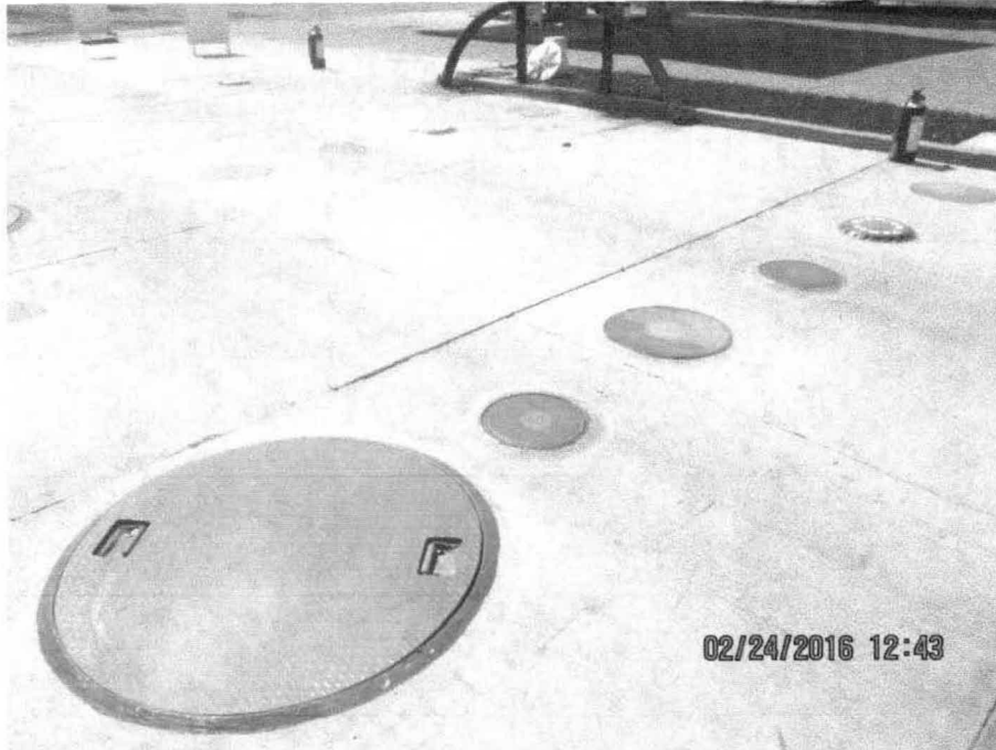
Fotografía No. 11.- Zona de tanques de almacenamiento de gasolina Premium
