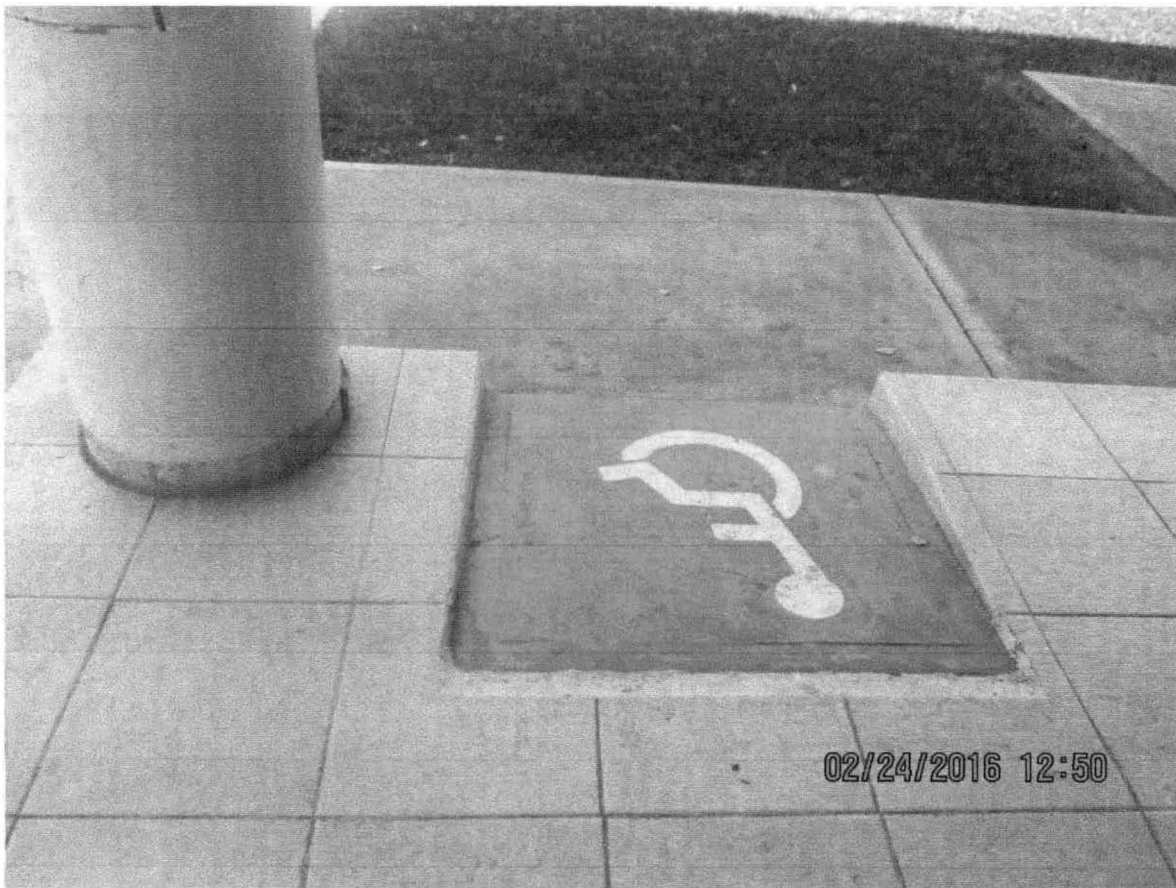
Fotografía No. 13.- Acceso a Discapacitados
