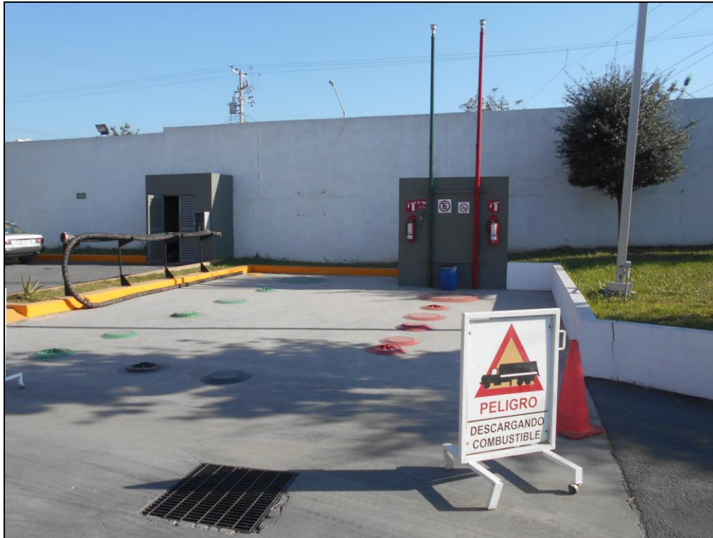
Figura 3. Área de tanques de almacenamiento.
