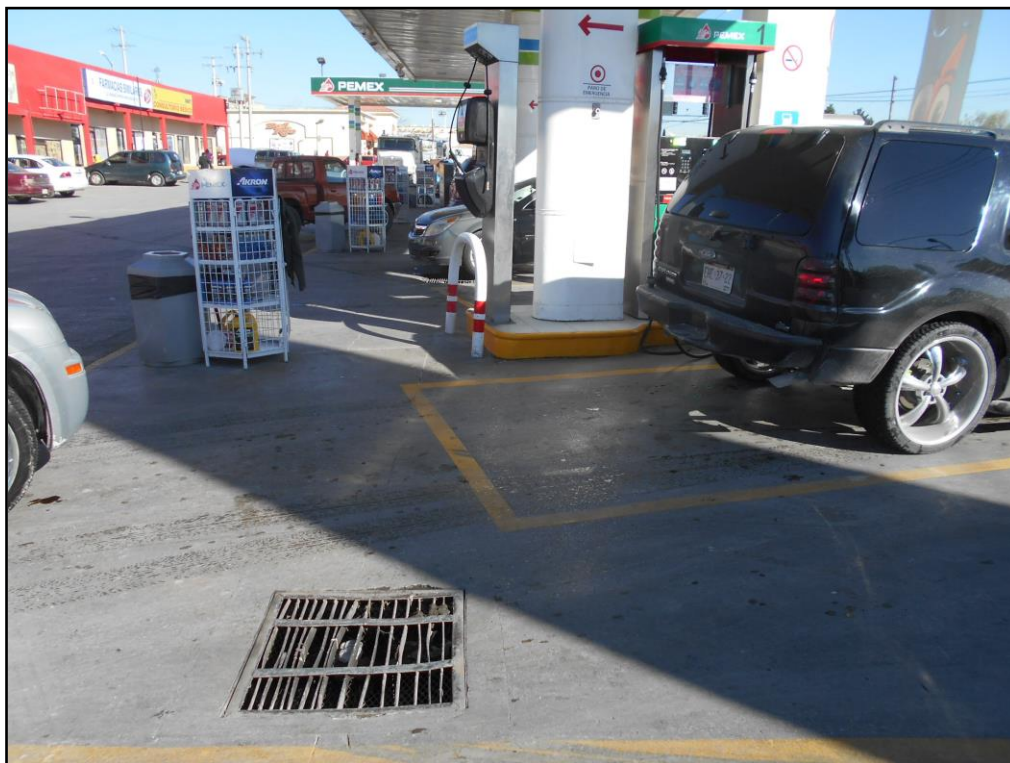
Imagen 4. Rejillas del sistema de drenaje aceitoso.
