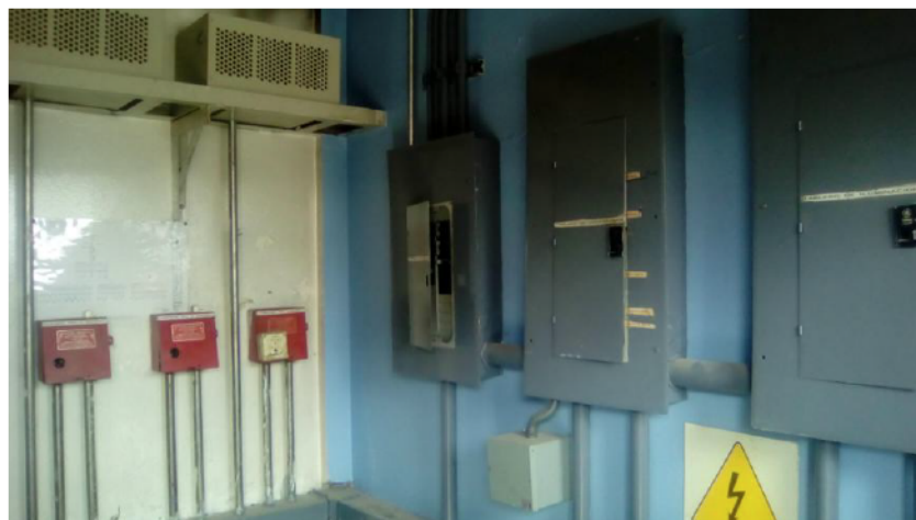
Foto 5. Cuarto de Controles Automatizados.
