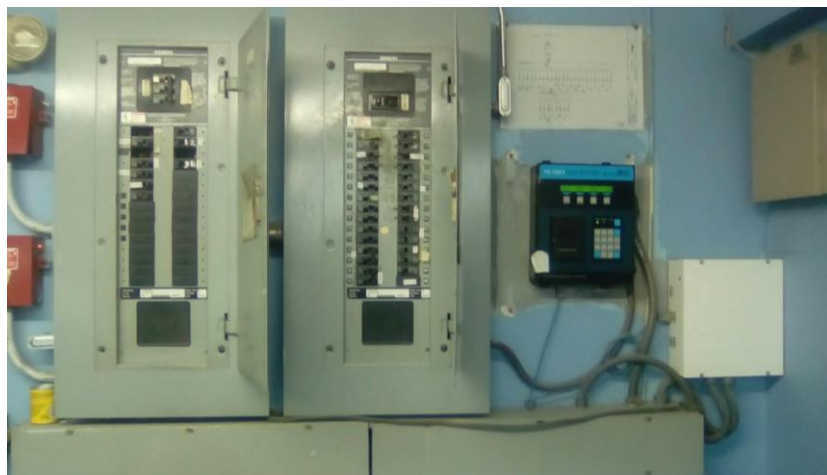
Foto 5. Cuarto de Controles Automatizados.
