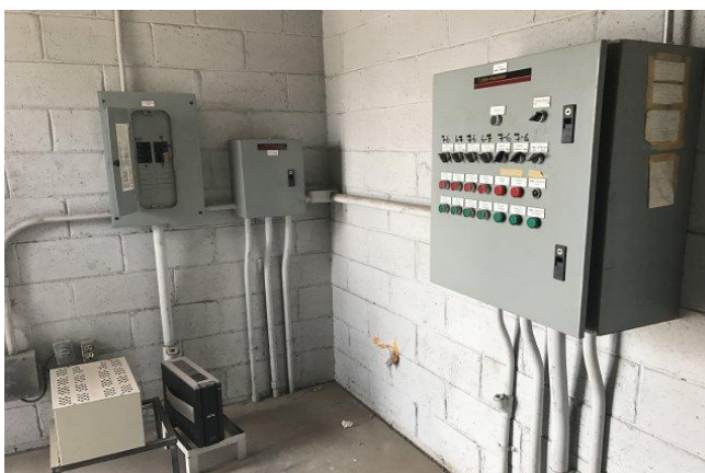
Foto 5. Cuarto de Controles Automatizados.
