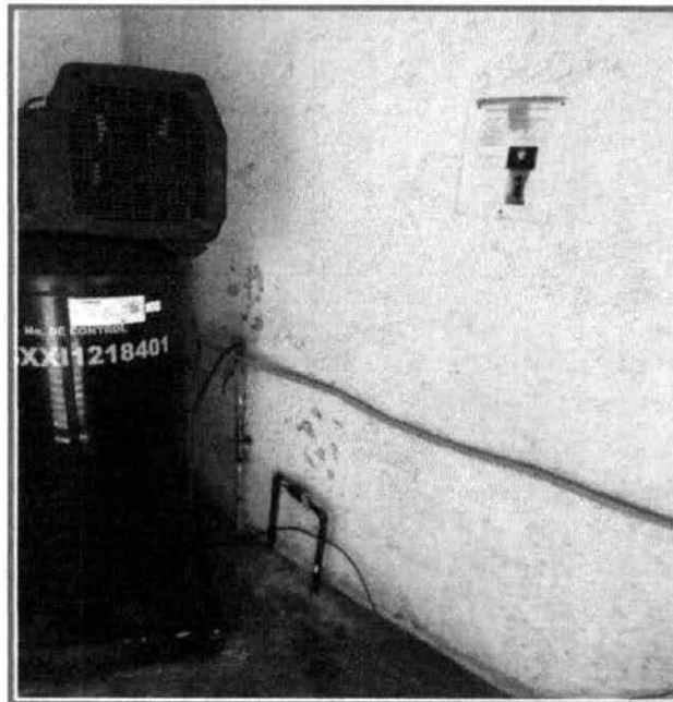
Fotografía 8. Se cuenta con un hidroneumático y un compresor dentro del cuarto de máquinas.
