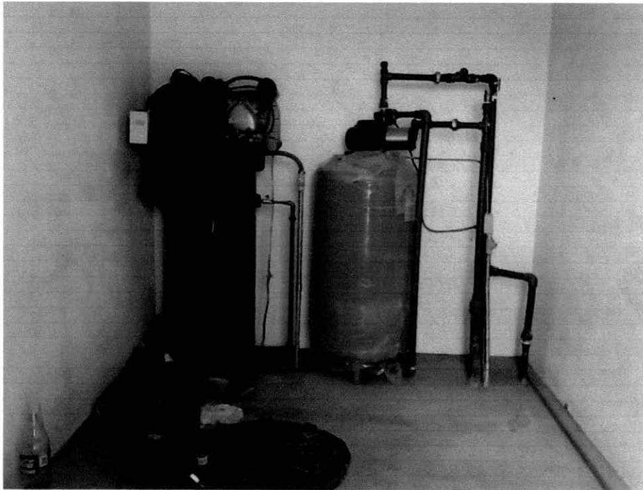
Vista del Cuarto de Máquinas
