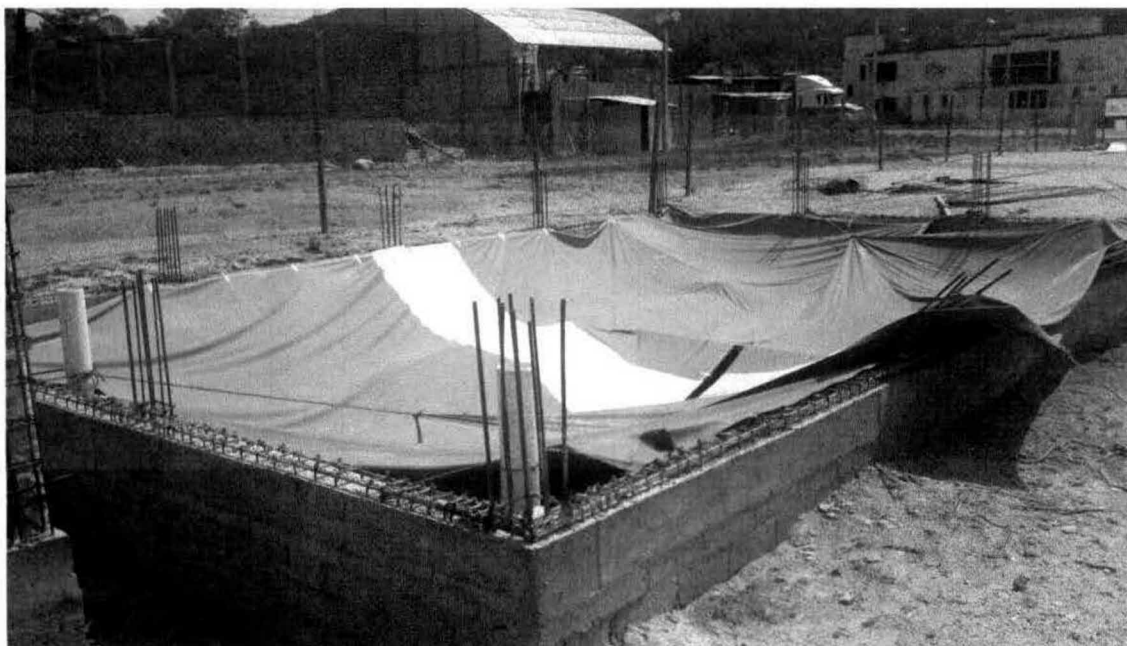
Vista de obras de la gasolinera (área de tanques) que se iniciaron
