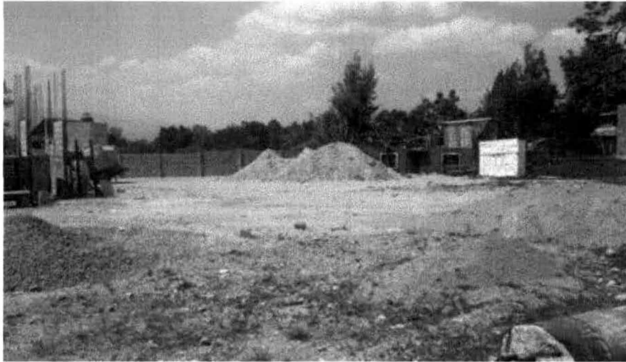
Vista de obras de la Estación de Servicio que se habían iniciado y dio origen al procedimiento administrativo instaurado por PROFEPA
