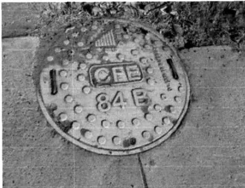
Figura 15.- Infraestructura de la Comisión Federal de Electricidad subterránea.
