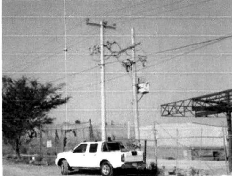
Figura 14.- Infraestructura de la Comisión Federal de Electricidad.
