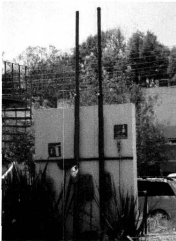
Figura 11. Válvulas de venteo instaladas en la estación de servicios. SAP Servicios Ambientales Profesionales
