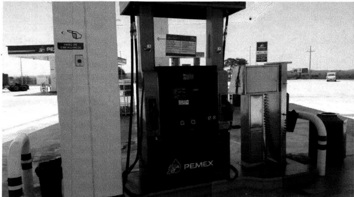
VISTA DISPENSARIO DE GASOLINAS.
