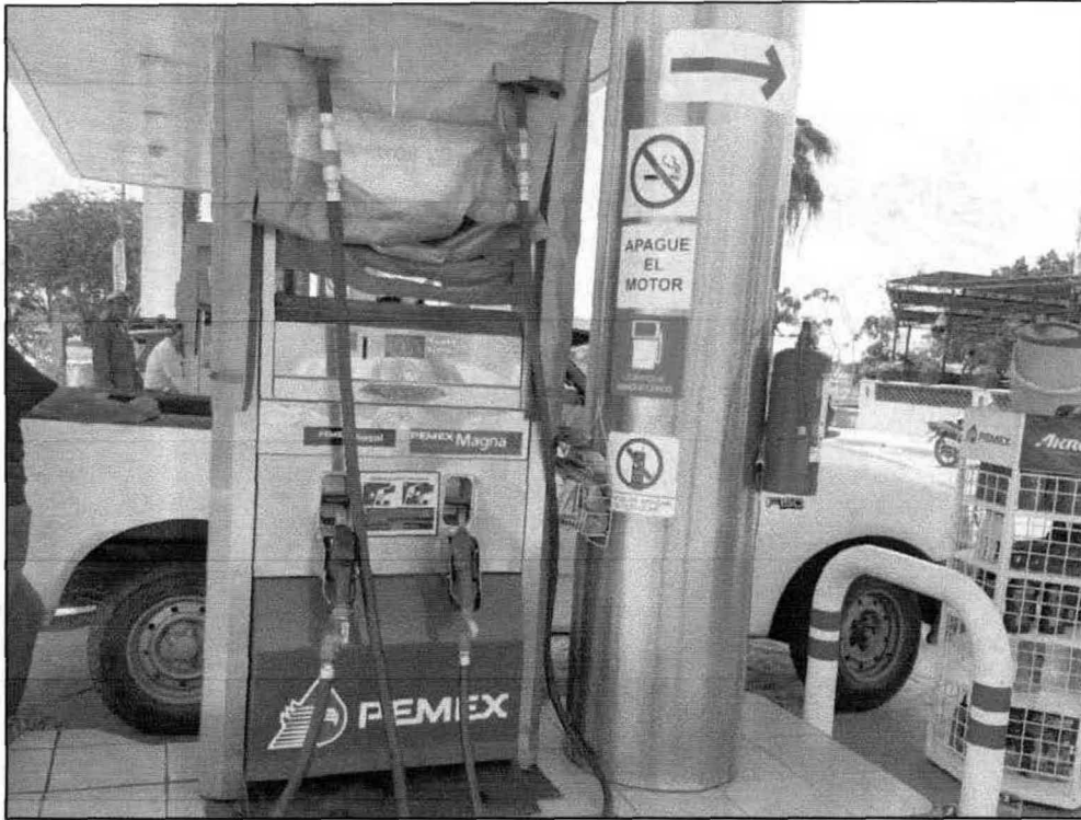
Fotografía 6. Modulo doble de gasolina Magna y Diesel.
