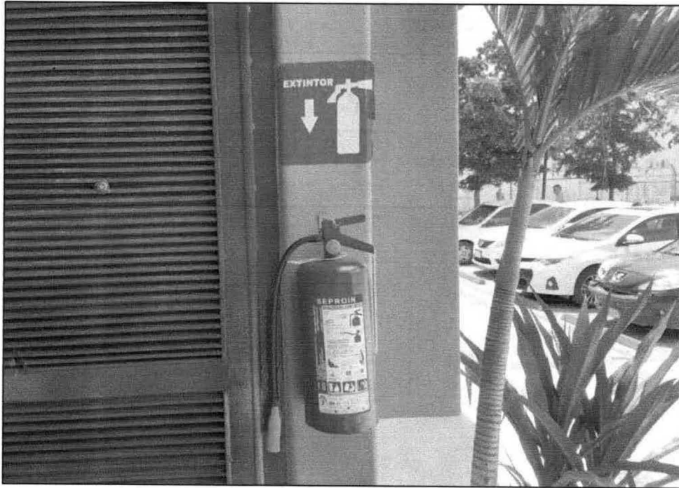
Fotografía 4. Equipo contra incendios en área administrativa.
