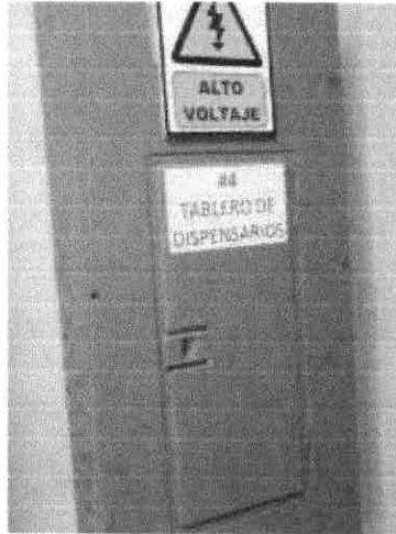
Figura 18. Tablero con instalación de monitoreo.
