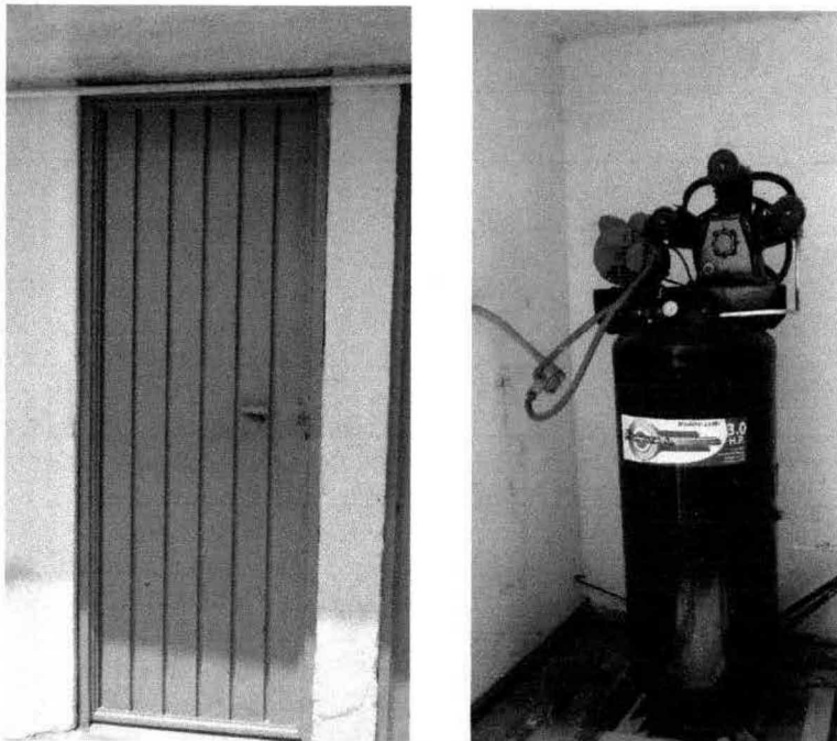
FIGURA 12. CUARTO DE MAQUINAS
