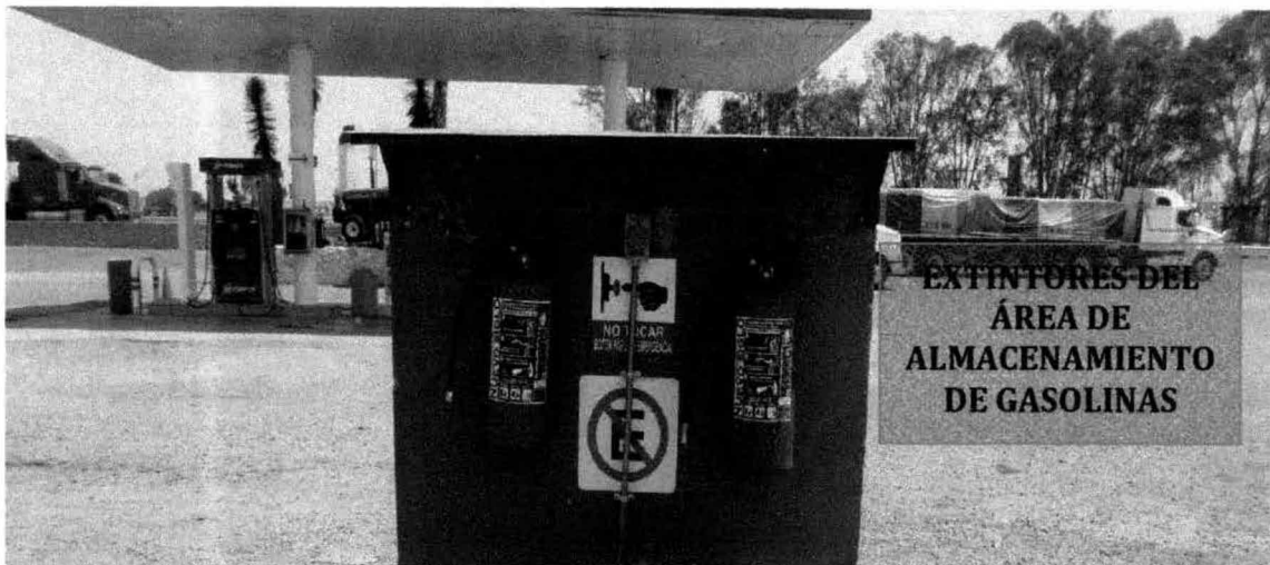
FIGURA 11. EXTINTORES EN ZONAS DE ALMACENAMIENTO DE COMBUSTIBLES
